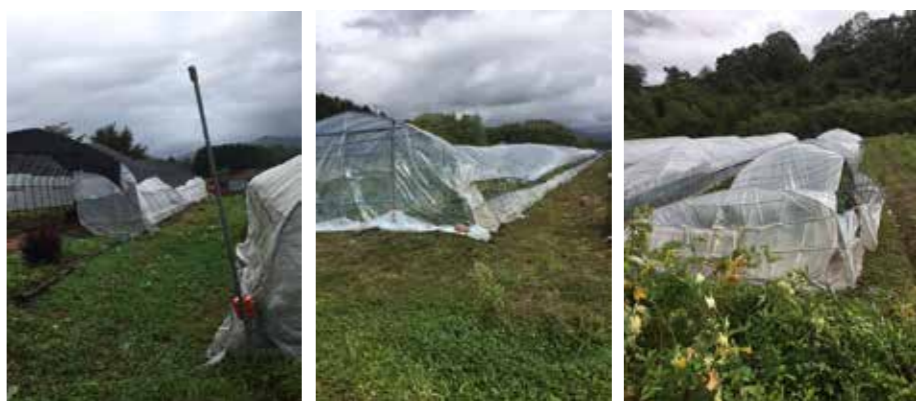
台風21号によるビニールハウス被害状況
