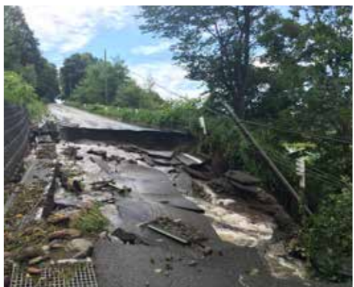
被災した道路（明和前川林線）
