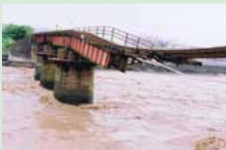
平成15年の水害で、大きく曲がった日高線の鉄橋
