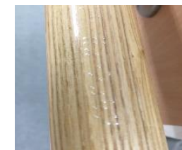
⑦手すりに点字シール
